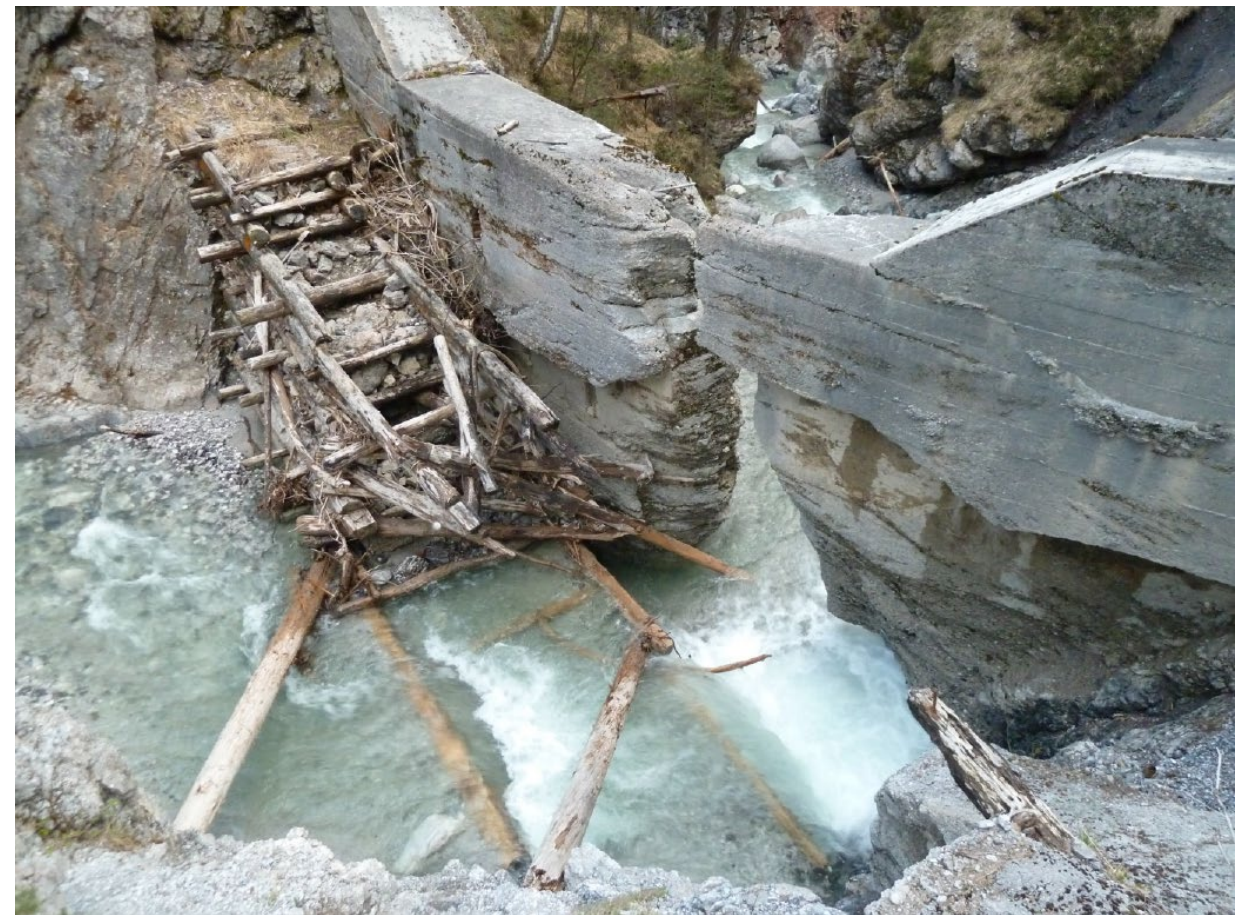
Hudourniška pregrada na hudourniku Belca v »vzdrževanem« stanju (foto: Manica Martinčič, 2012).
