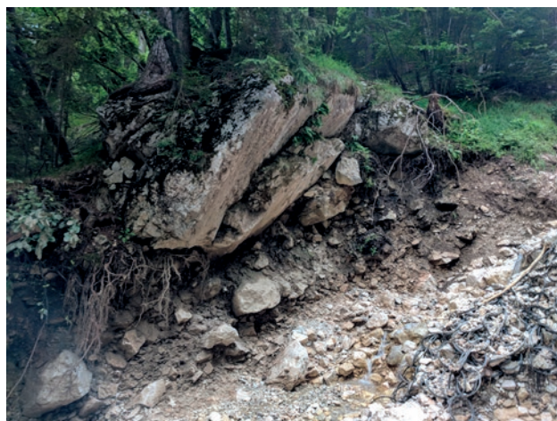
Slika 10: Porušena fleksibilna mrežna pregrada.
