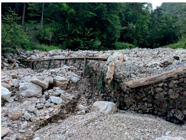
Slika 9: Poškodovani pragovi iz gabionov in kašt.
