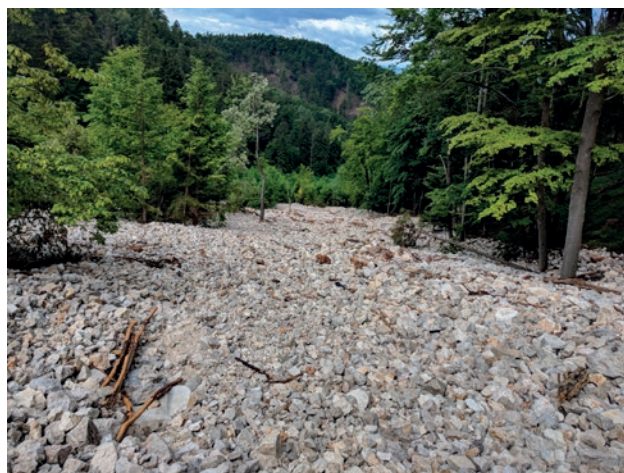
Slika 4: Odložen material na Lukenjskem grabnu – prekrito celo dolinsko dno
